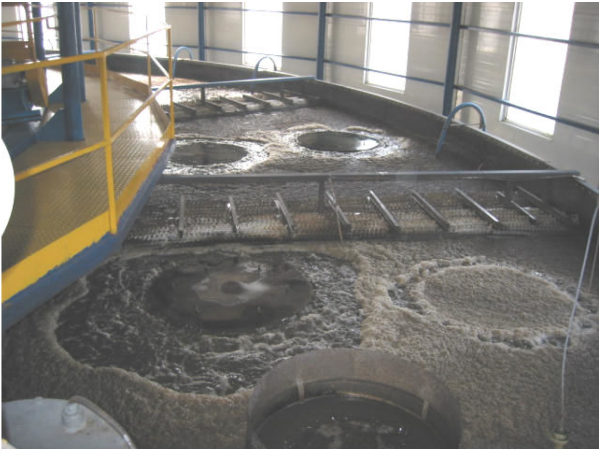
Widok pracujących aeratorów w oczyszczalni ścieków w Paczkowie
